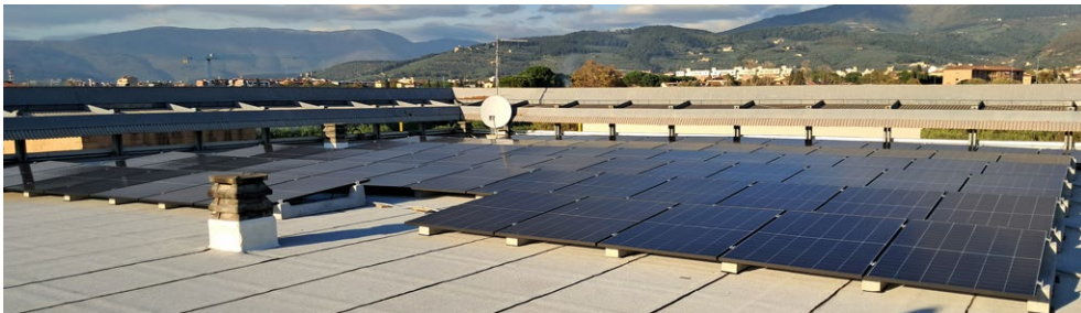
Figura 12. Nuovo impianto fotovoltaico su copertura CERM
